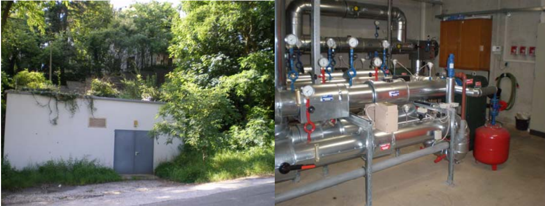
Fernwärmezentrale Weinberg von außen und innen
