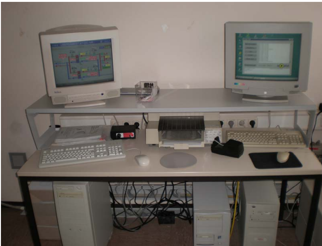
Gebäudeleittechnik und Fernwärmelecküberwachung
